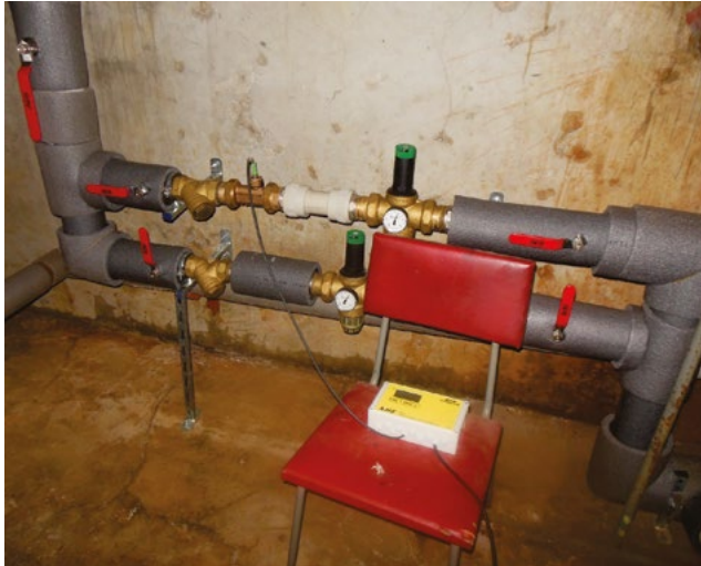
Obr. 1 Osazení průtokoměru CONTROL-PLUS a měřicí ústředny KHS-Mini MASTER 2.0 v druhém bytovém domě.
