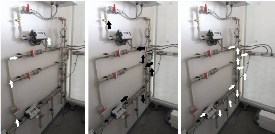
Obr. 3 Variantní zapojení systému rekuperace v rámci TG celků (vlevo bílá trasa, uprostřed černá trasa, vpravo šedá trasa), fotografie pořízené na AdMaS VUT v Brně.
