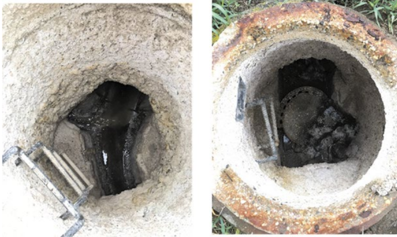
Obr. 2 Ukázka koroze betonového zdiva.
